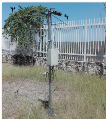
Figura 4. Estación meteorológica instalada en la facultad de ingeniería
